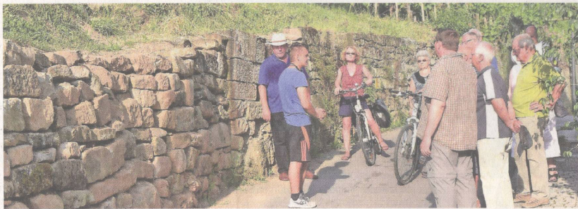
Bei der Ortsbegehung – hier in der Felsenstraße – informieren Anlieger und Wengerter (links) Klingenberger Bürger und Mitglieder der Freien Wähler über den aktuellen Zustand des 700 Meter langen Nagelfluhfelsens. Foto: Heiner Dörner
